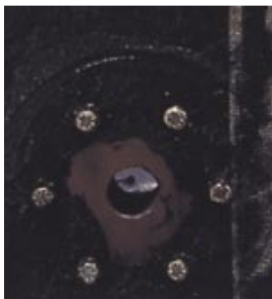
Miejsce przechodzenia rur przy spiętrzonej wodzie i wodzie ciśnieniowej.
