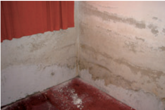
pogorszenie mikroklimatu pomieszczeń
